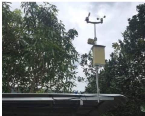
ภาพที่ 7 การติดตั้งเซนเซอร์ตรวจวัดสภาพอากาศ
